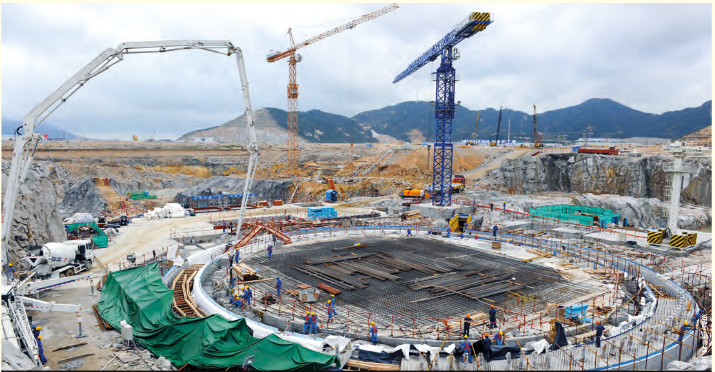
Le 10 février 2010, quelques semaines après le coulage du premier béton de l'unité 2, l'enceinte de l'îlot nucléaire se devine déjà, avec ses murs épais de 2,6 mètres (contre 1,2 mètres pour les tranches N4 du parc français et 90 cm pour celles du palier 900 MWe)
