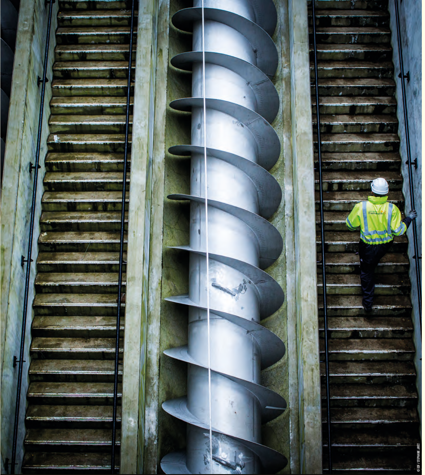
Station de pompage de l'EPR de Flamanville : vis d'Archimède, d'une longueur de 16 m et d'un poids de 6 tonnes, elle assure la remontée de l'eau collectée dans l'ouvrage de pré rejet avant qu'elle ne retourne à la mer
