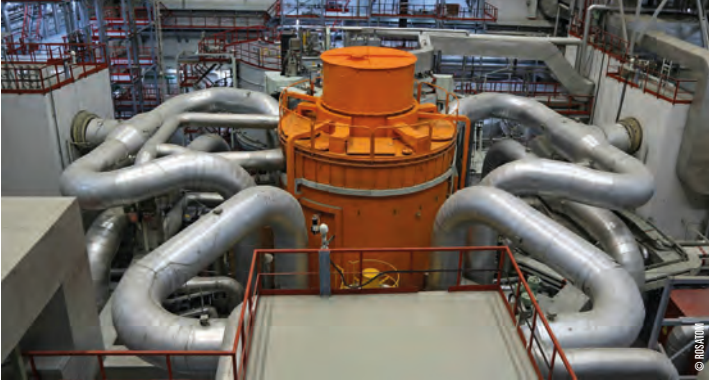
Figure 2 : vue des trois circuits secondaires sortant du bloc réacteur en direction des générateurs de vapeur
